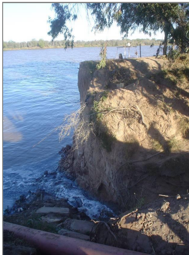
Figura 29. Canal de desagüe del Parque Industrial.
